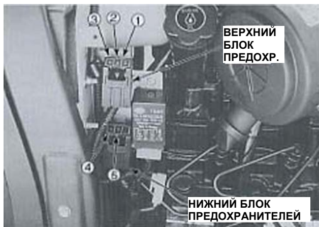
Рис. 71. Главные блоки предохранителей
